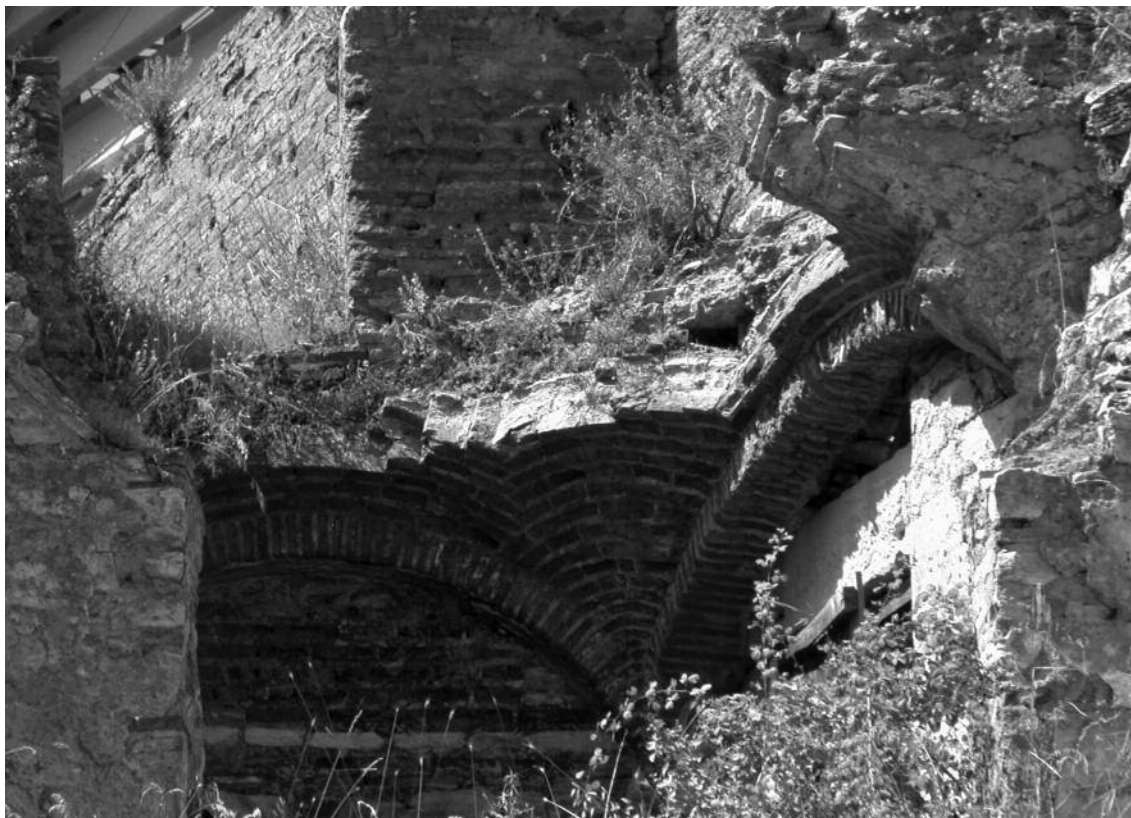
Fig. 18. Efeso volta a vela con archi di mattoni affiancati in un edificio della strada dei Cureti . Notare la disposizione dei mattoni di testa.
